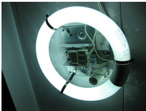
取替前（蛍光灯）
